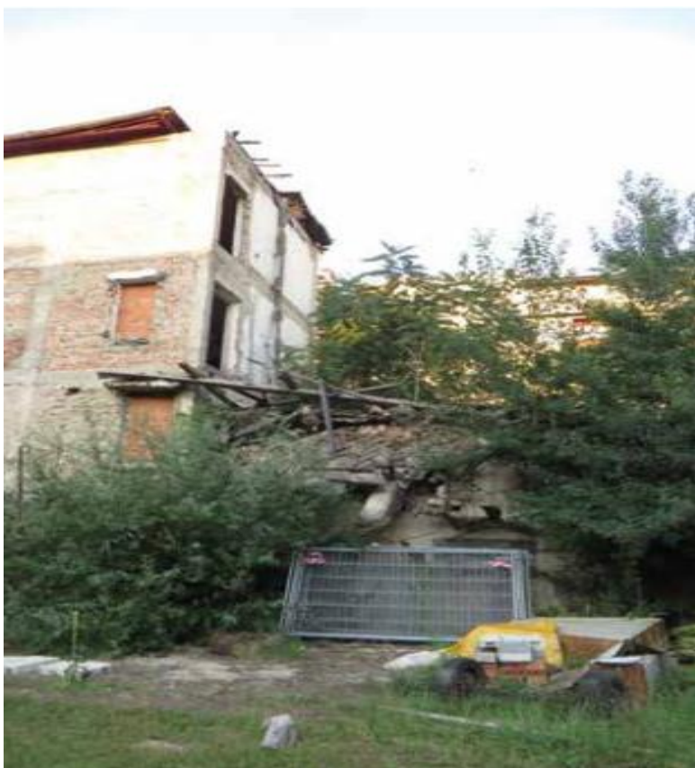
Sl.12: Detalj urušenog dijela (bivša zgrada za dobrobit radništva)
