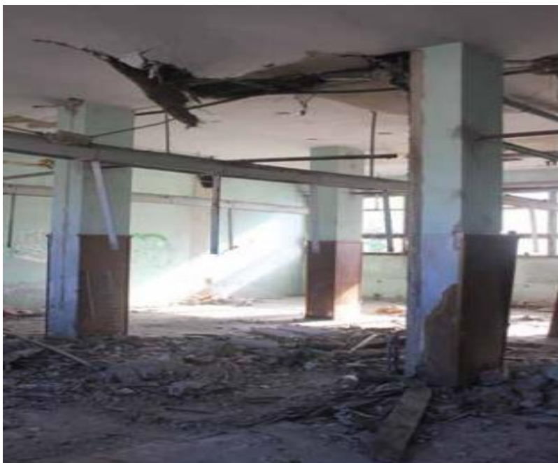
Sl.11: Oštećenja u unutrašnjosti tvornice
