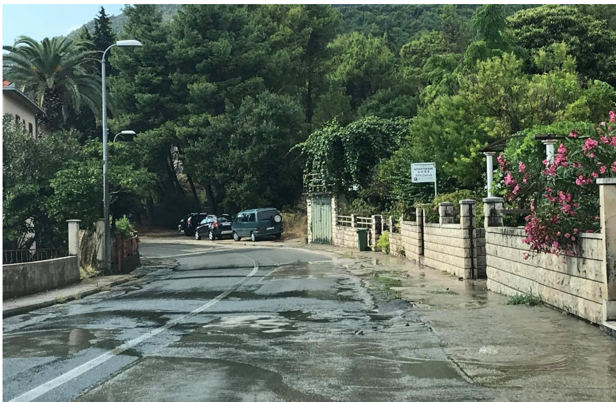
Sl. 10. Loše stanje ceste D-414 u Orebiću
