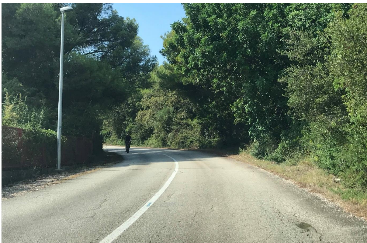
Sl. 11. Izlizan i raspucan asfalt na županijskoj cesti 6215 Orebić - Lovište
