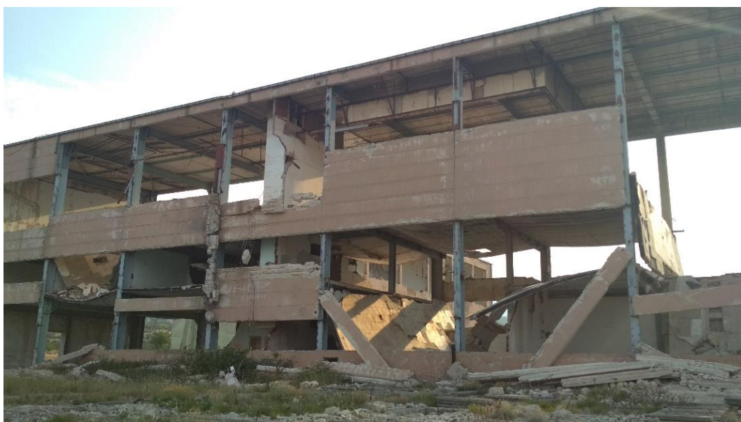
Slika 16. Ruševno stanje jedne od preostalih zgrada tvornice Jadral, 24.8.2019.
