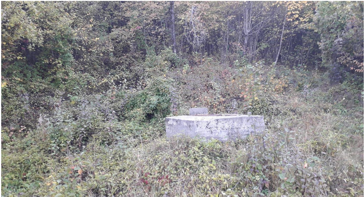
Sl. 11. Sabirni bazen vodovoda Glavice (7. srpnja, 2019.)
