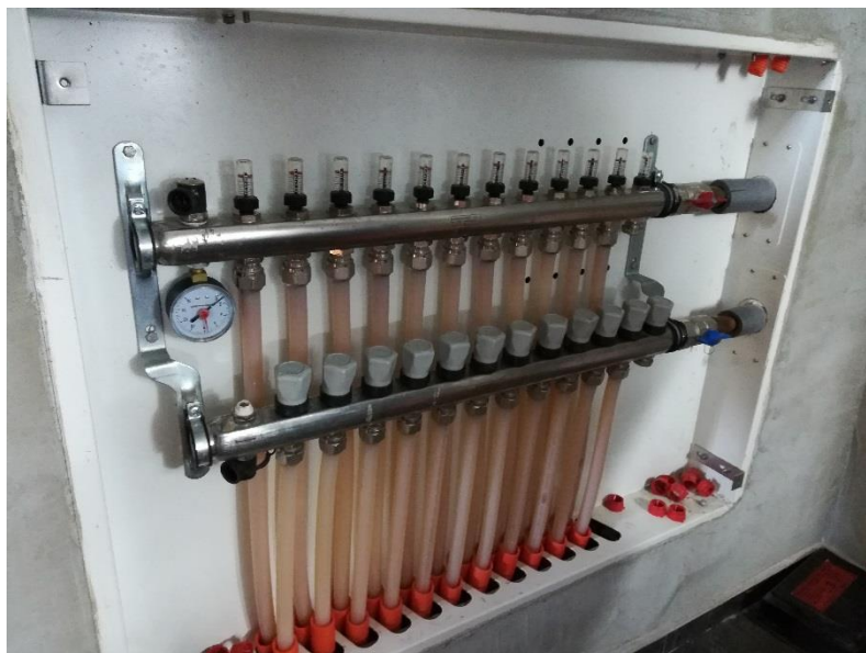
Slika 8. Sustav podnog grijanja u vodenom parku Aquae vivae (Preuzeto sa HGI-a; foto: I. Bobovečki)
