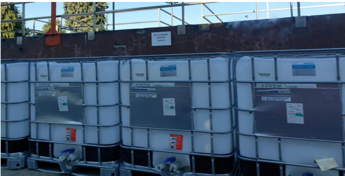
Sl.26. Spremnici za otpadni mulj Izvor: Vlastite fotografije (2020.)
