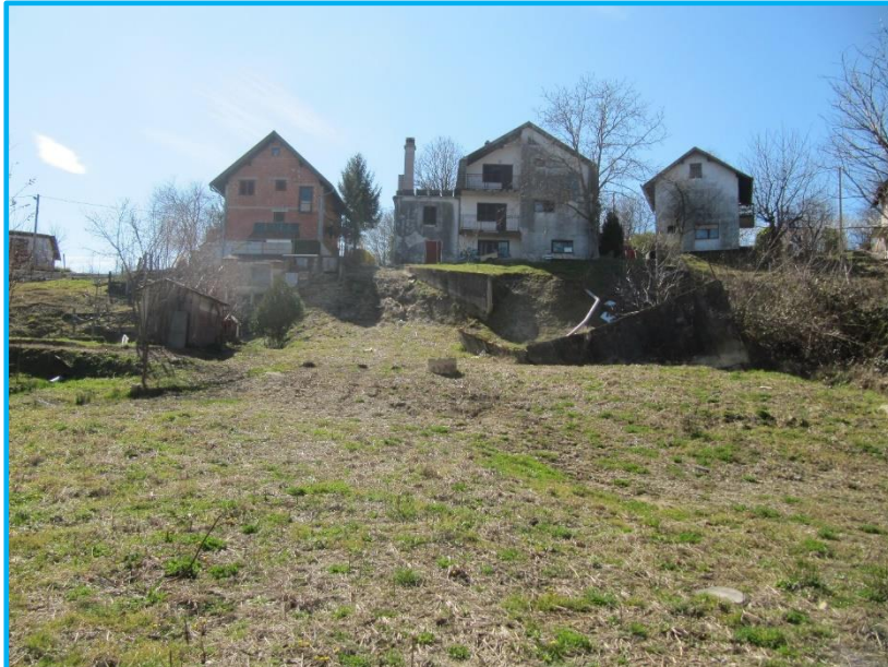
-Photo 263- prokopan kanal u tijelu - kroz kanal se cijedi voda
