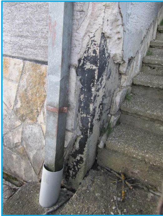
Photo 233,9-pogled iza kuće, gornji dio klizišta
