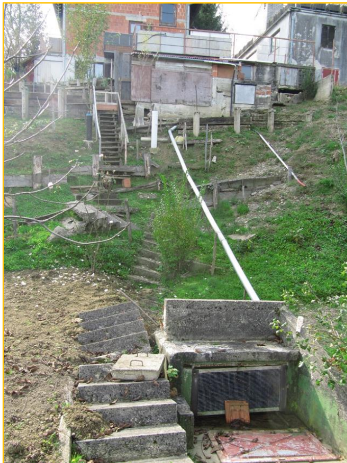
Slika 27. Oštećeni kaptirani zdenac, „proklizale stepenice“ i cijevi koje odvode oborinske vode u tijelo padine (fotografirano tijekom terenskog kartiranja 2020. godine).
