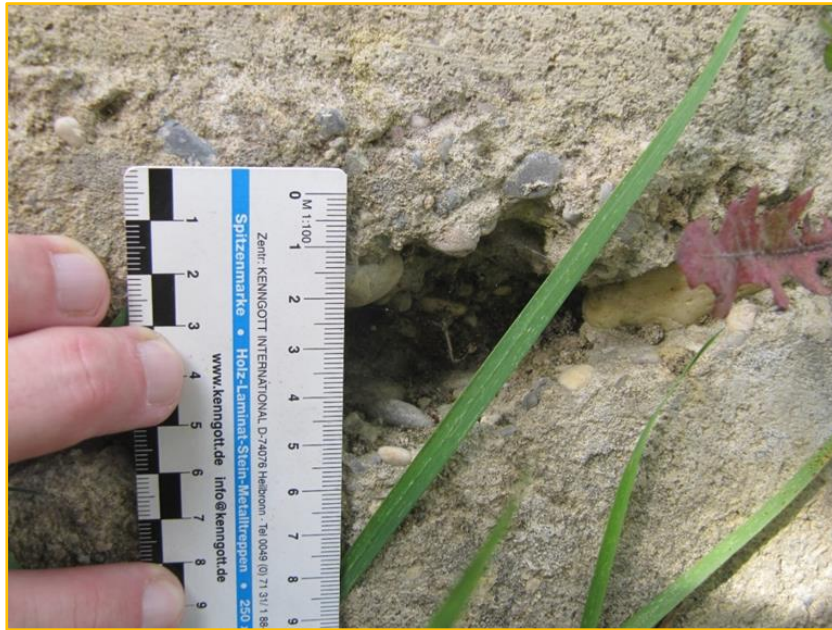
Slika 33. Prvo mjerenje zijeva pukotine D1 - pukotina do 5 cm (listopad 2019. godine).
