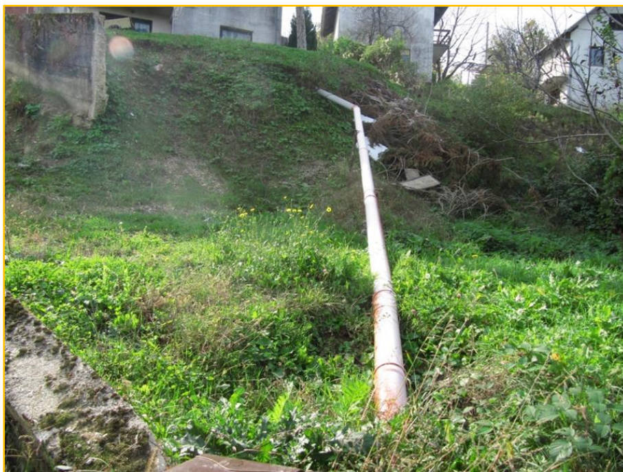
Slika 35. Čeona pukotina ispod stabla iz koje izlazi siva PVC cijev na koju se nastavlja narančasta PVC cijev za odvodnju (fotografirano tijekom terenskog kartiranja 2019. godine).
