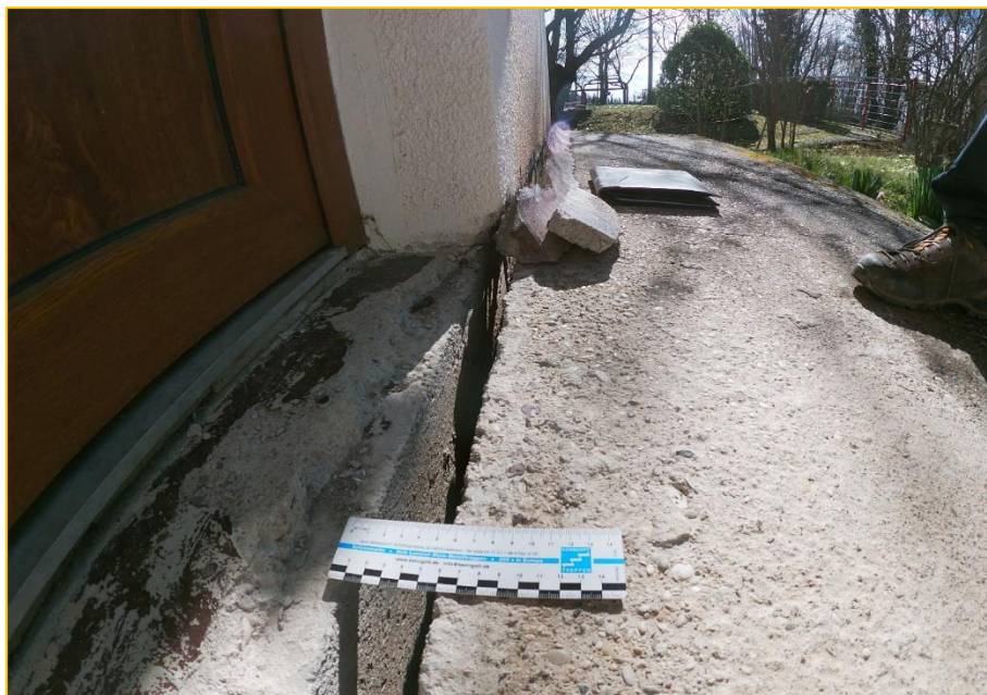
Slika 41. Mjerenje pukotine D4c (ožujak 2020. godine).
