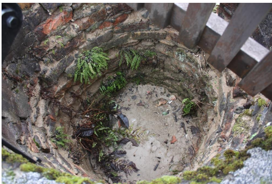
Slika 5. Bunar zatrpan sedimentom na lokaciji S66_1.
